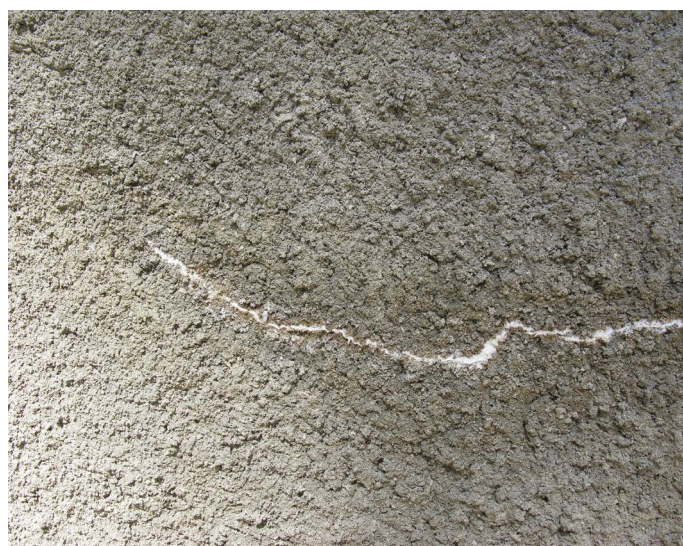
2. La cicatrizzazione di una fessura nello spritz beton grazie all'effetto della cristallizzazione
